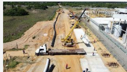
Instalações de Superfície e Abaixamento de Tubos
